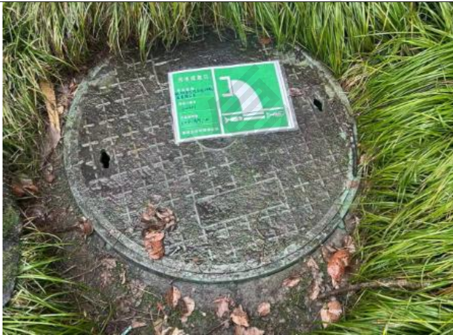
污水排放口及标识标牌
