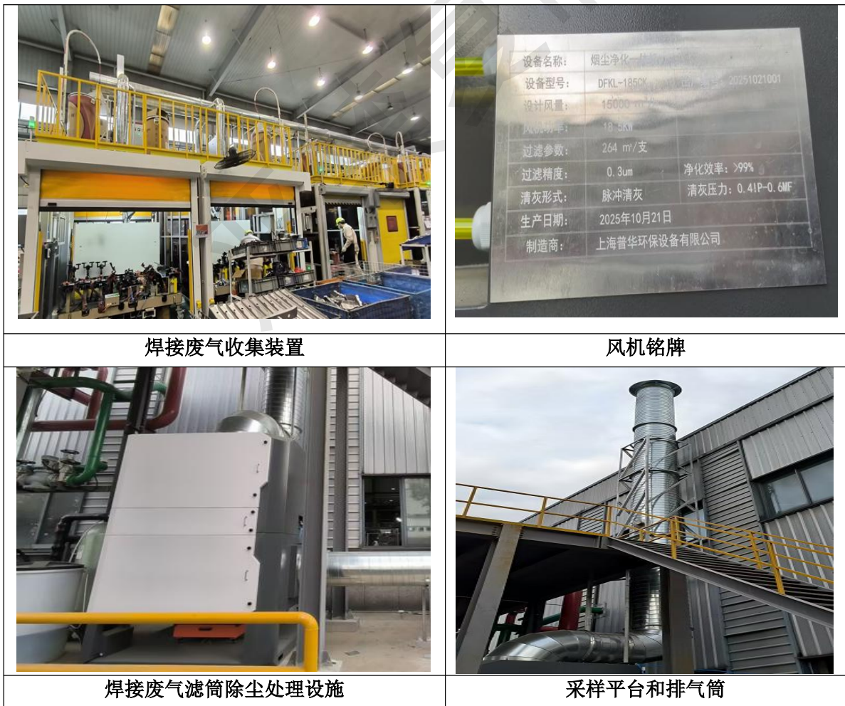
图 3-2 废气处理设施现场图
