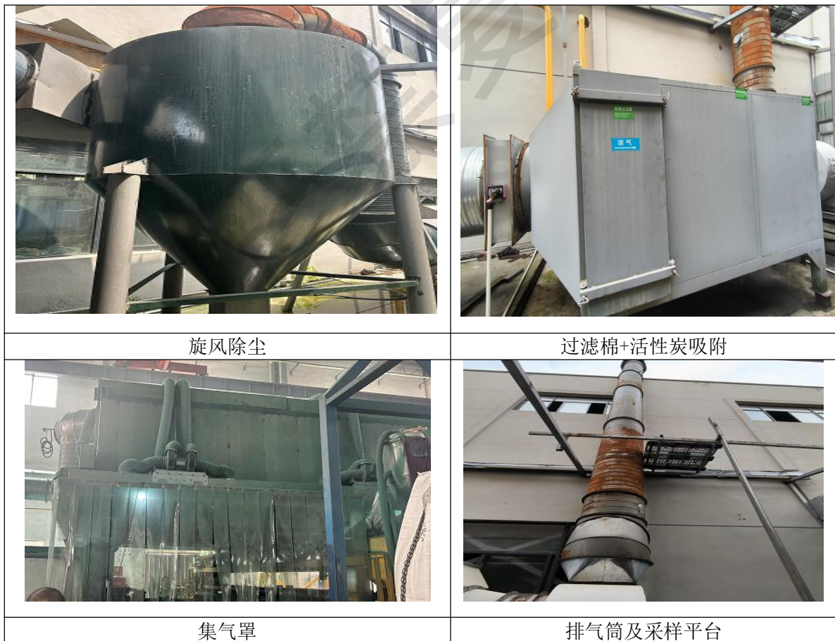
图 3-2 废气处理设施、排气筒现场图
